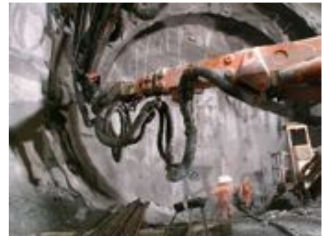
Im Vortrieb des „Einspurtunnels Ost Süd“ kommen im Gegensatz zum Bau des Simplons leistungsfähige Maschinen zum Einsatz, die den Menschen einen großen Teil der Arbeit abnehmen. Der Gotthardbasistunnel wird im endgültigen Ausbaustadium eine Länge von 57 Kilometern haben. Er ist dann, wie seinerzeit der Simplontunnel, der längste Tunnel der Welt.
